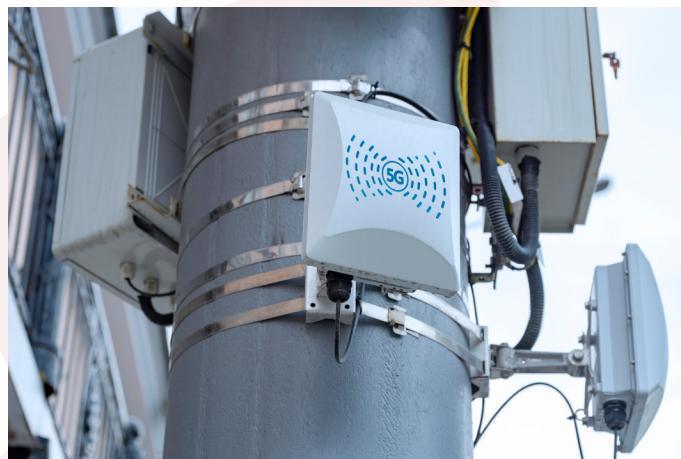
Slika 3 – 5G antena postavljena na baznu stanicu
