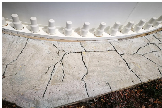
Slika 1 – Pukotine u betonu 1
