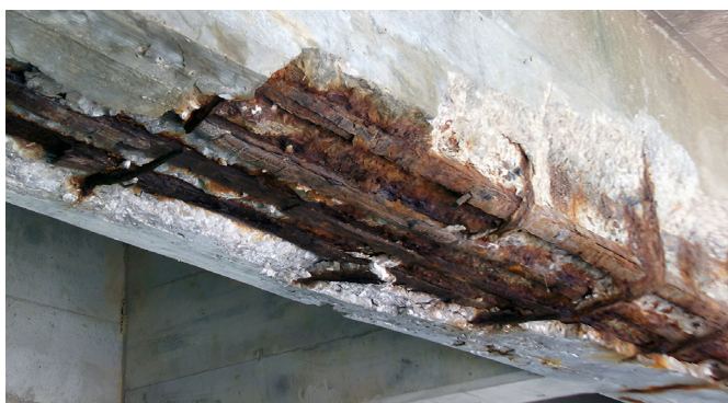
Slika 2 – Korozija u betonu 3
