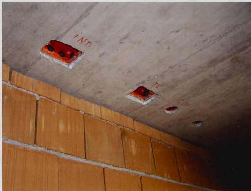
Mjesta u stropu za priključke instalacija
