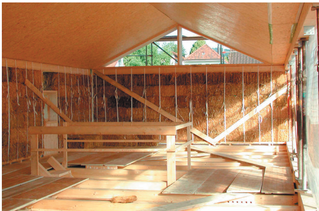
■ Primjer gradnje i gotove kuće sa zidovima od slame u Wahlen bei Laufen, Švicarska
