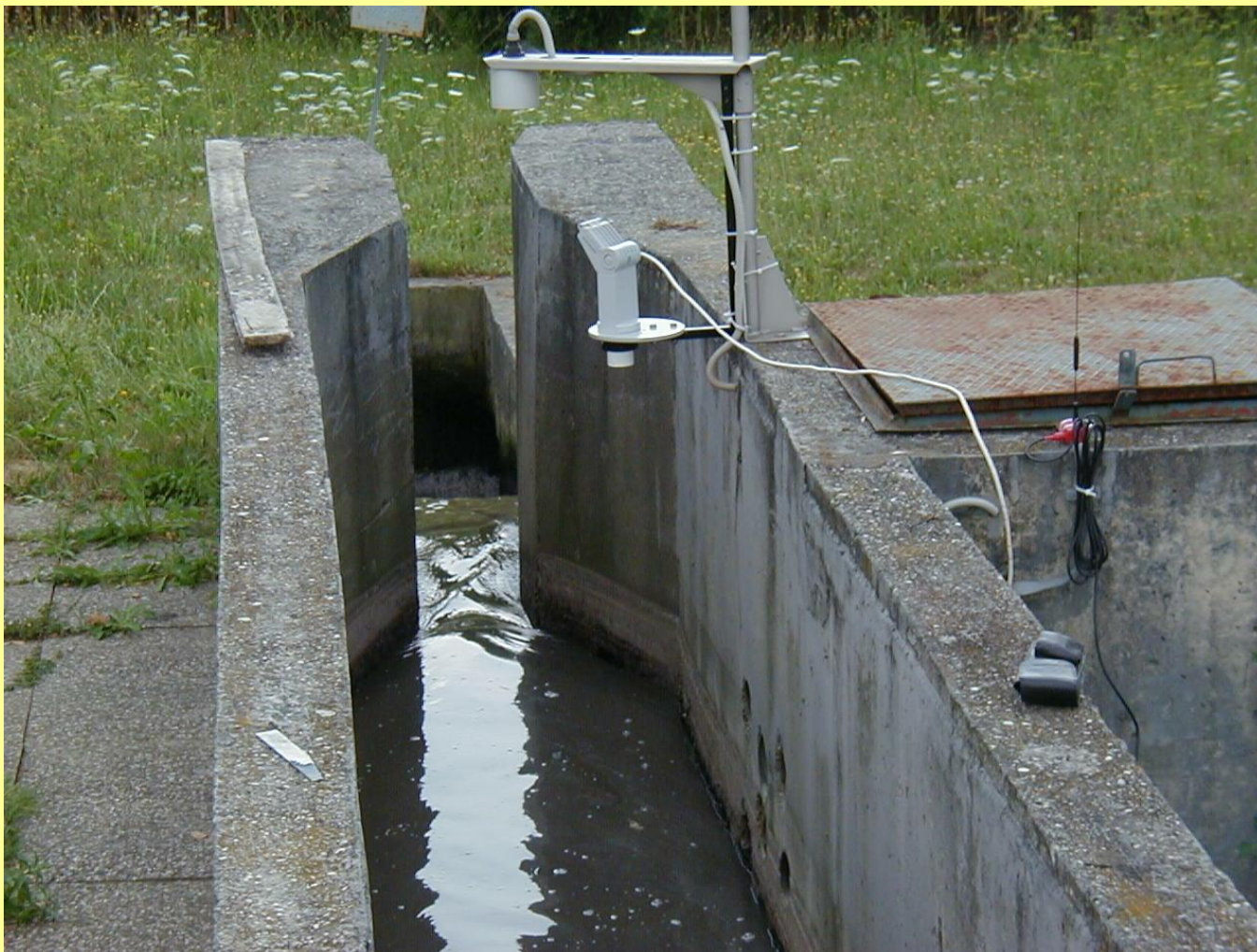
Mjerni kanal s instaliranim mjeracem razina na izlazu uređaja za pročišćavanje otpadnih voda grada Križevaca
