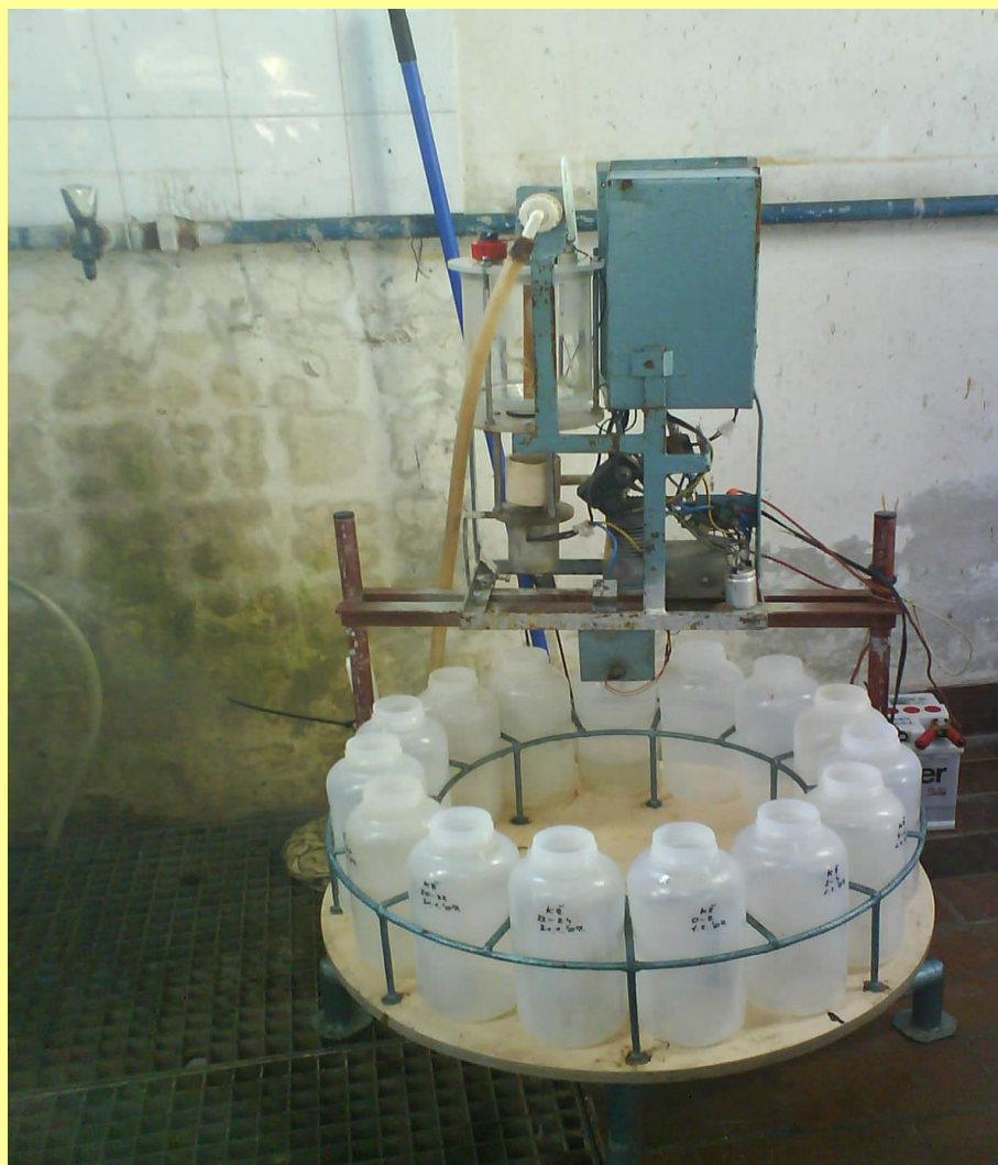
Automatski uzorkivač na ulazu uređaja za pročišćavanje otpadnih voda grada Križevaca
