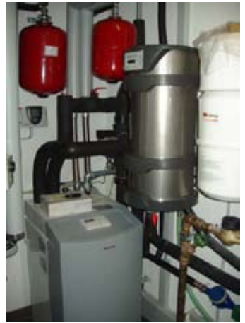
■ Postrojenje dizalice topline
